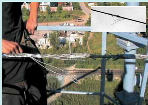
Рис. 4. Фрагмент повреждения ОКГТ от разряда молнии
