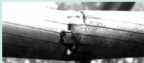
Рис. 13. Усталостное повреждение провода ПА-640
