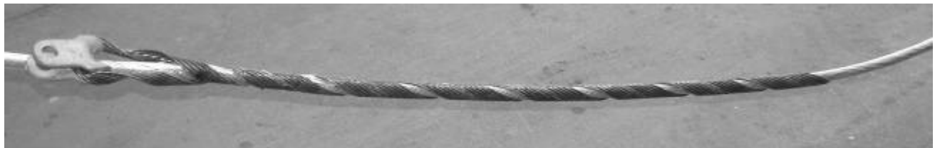
Рис. 8 Натяжной зажим на проводе.
