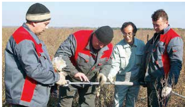
Рис. 2. Устройство натяжного оконцевателя провода GTACSR 217/49 с дополнительной герметизацией зазора между оболочкой и сердечником перед опрессовкой (Краснодарский край, 2009 год)
