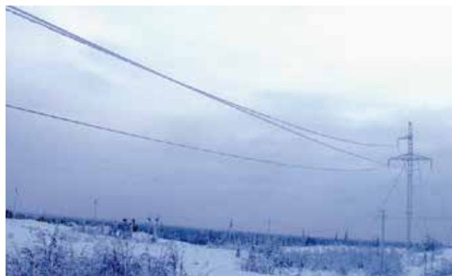
Рис. 4. Один из пролетов заполярной ВЛ 220 кВ «Газлифт – Северный Возей» (ОАО «АЭК Комизэнерго», 17.02.2006), находящихся в состоянии низкочастотной вибрации-пляски (частота 0,5–4 Гц, амплитуда 2–3 диаметра провода); после ремонта в 2007 году с вытяжкой проводов в 5 пролетах с устранением излишних провисов по сравнению с расчетной стрелой низкочастотная вибрация прекратилась; аварийный грозотрос был снят раньше
