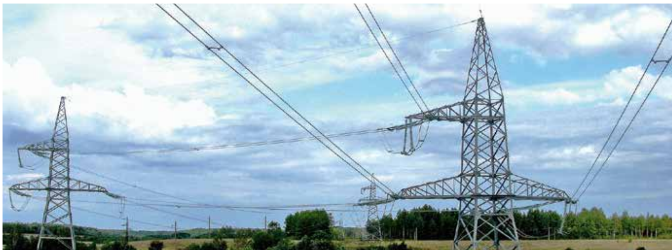
Рис. 3. Применение современной линейной арматуры ЗАО «Электросетьстройпроект» на ВЛ 330 кВ «Гатчинская – Лужская» при подвеске проводов АС-300/39 и ОКГТ (OPGW 17A 45Z): внутрифазные дистанционные распорки-гасители 2РД-400В-31 и 2РД-600В-31; натяжная и шлейфовая соединительная спиральная арматура (2011)
