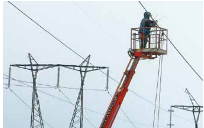
Рис. 7. Оперативный ремонт старого провода марки САГ-228 (Севкабель – 1933 год) на ВЛ 220 кВ посредством специально изготовленного натяжного спирального соединителя длиной 16 м; работы по устранению повреждения выполнены силами Выборгского ПМЭС и ЗАО «Электросетьстройпроект» (04.02.2014)
